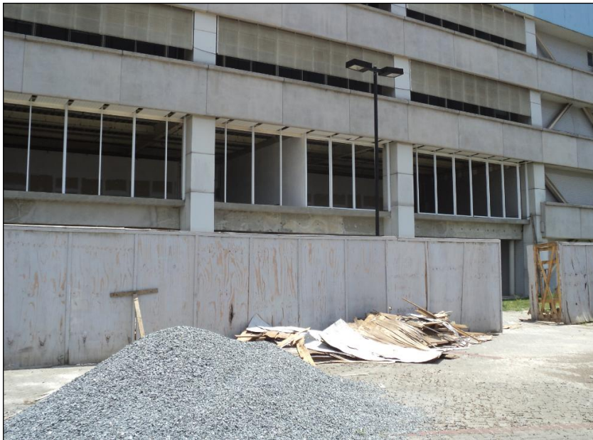
Foto nº 4 - Prédio II com suas obras de ampliação paralisadas:
