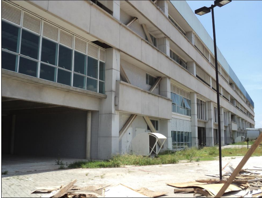
Foto nº 3 - Prédio II com suas obras de ampliação paralisadas:
